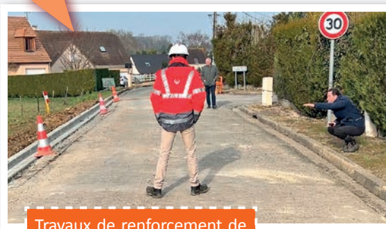
Travaux de renforcement de la canalisation des bouches d'incendie, rue de Beaulieu.
